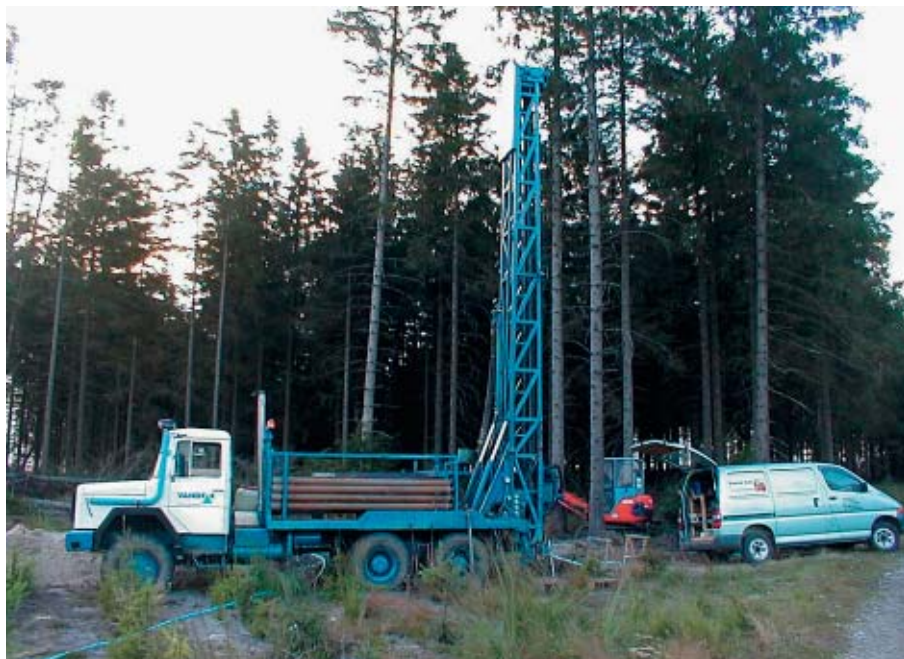
Borerig til udførelse af en drikkevandsboring. Til højre ses en loggingbil, hvorfra der udføres borehulslogging i det åbne hul med gammalog, resistivitetslog, induktionslog, fluid-resistivitetslog og spektral gammalog før borningsudbygning. (Foto: Henrik Andersen, Dansk Geofysik A/S)
