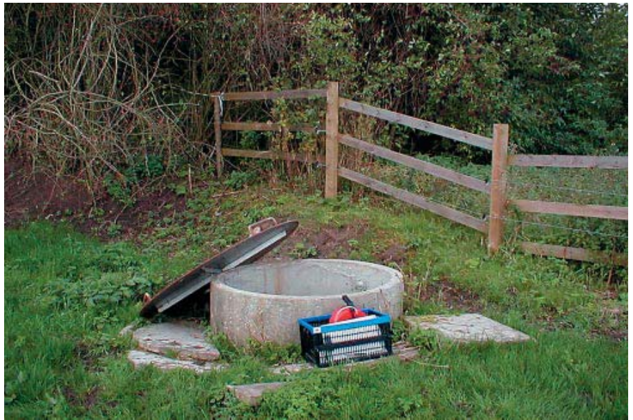
Fritliggende boring beskyttet af brøndring af cement og ståldæksel. Boringen anvendes til forsyning af en enkelt husstand (Foto: Rovesta Miljø)
