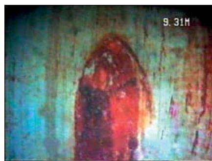
Tærede skrue er efterhånden et klassisk problemområde i indvindingsboringer – dette er et særligt grelt eksempel på en tæret skrue. (Foto: Henrik Andersen)
