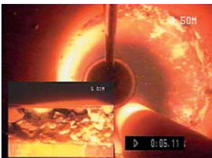
Anvendelsen af de nyeste forerørstyper – her PE-rør – med gevindsamling er ingen garanti mod menneskelige fejl; røret er knækket i samlingen. (Foto: Henrik Andersen)
