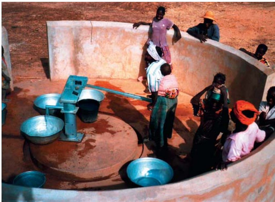
Håndpumpe af typen India Mk II installeret i boring udført i forbindelse med projekt PEEN. Betonplatform og mur er konstrueret for at sikre gode hygiejniske forhold omkring boringen. (Foto: Forfatteren)
