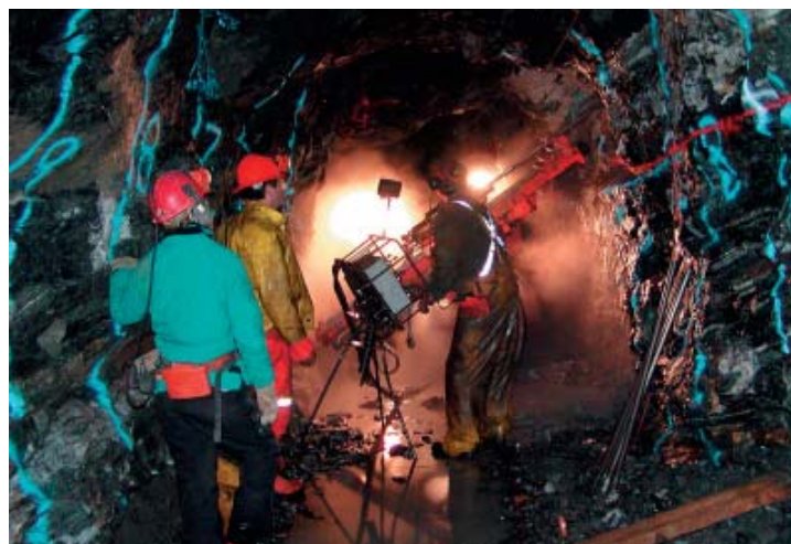
Når minen går i produktion skal Longhole-maskinen bruges når malmen skal brydes. Her er den igang med testbrydningen på Level 400. (Foto: Nalunaq I/S, J.P. Ringwald)
