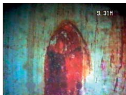
Tærede skrue er efterhånden et klassisk problemområde i indvindingsboringer – dette er et særligt grelt eksempel på en tæret skrue. (Foto: Henrik Andersen)
