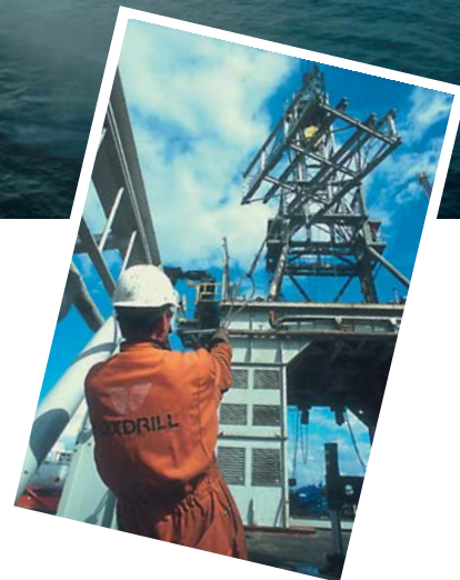
Arbejde på boreriggen Deutag T-2000 ved DONGs gaslager i Stenlille. (Foto: Niels Åge Skovbo)
